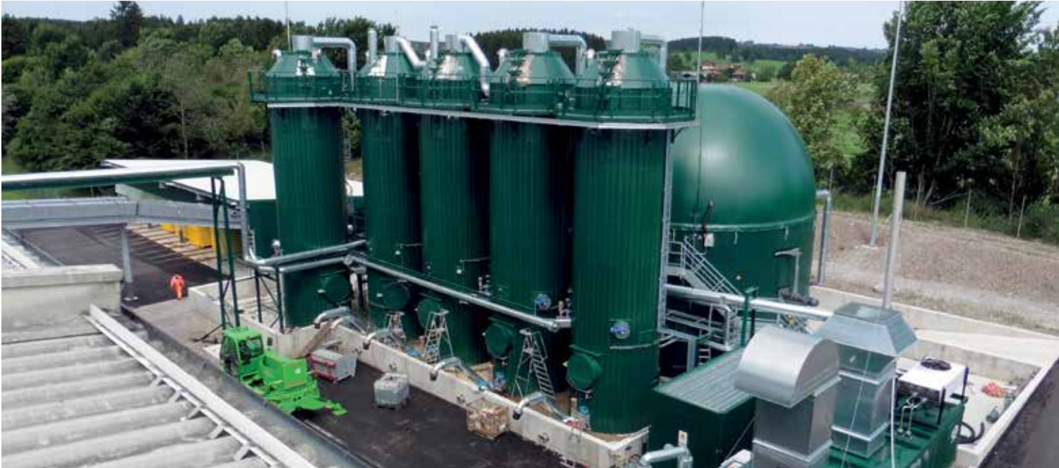
Die neue Vergärungsanlage mit den zylindrischen Fermentern und dem Rührkesselfermenter dahinter. Rechts ist das Blockheizkraftwerk zu sehen.
