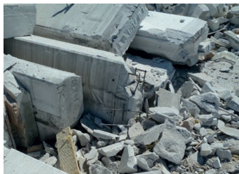
Auch für Gasbetonsteine müssen ab Januar höhere Entsorgungsgebühren gezahlt werden.
