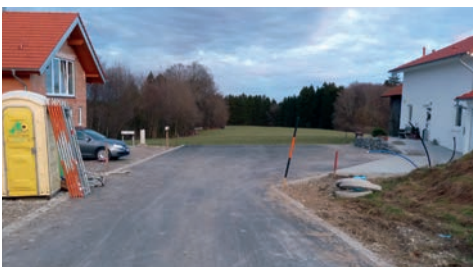
Neubaugebiet. Der Wendehammer ist zu klein. Ein Müllfahrzeug kann dort nicht problemlos umdrehen. Dabei sind die Vorschriften zur Unfallverhütung eindeutig.
