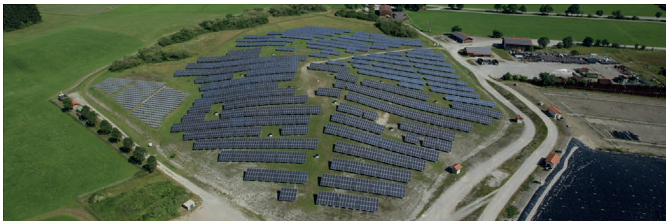
Die Photovoltaikanlage der EVA GmbH in Erbenschwang: 6.129 Module erzeugen eine elektrische Leistung von 1.528 Kilowattpeak (kWp).
